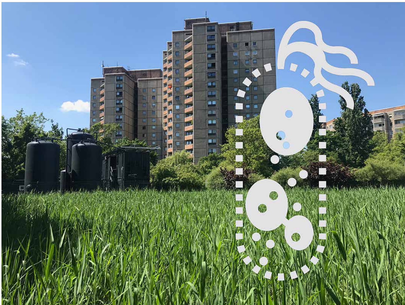
Grundwasserreinigungsanlage am Standort des ehemaligen Gaswerks Foto: Club Real
